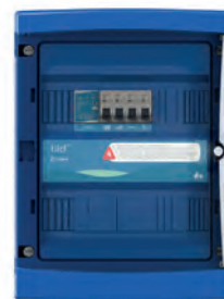
Cuadro iluminación Tide - Vigipool
